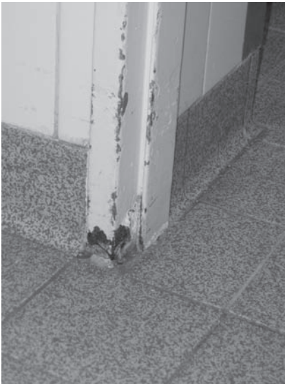
Bild 30: Schäden am Türstock unten (Quelle: Gemex Hygiene und Vorrats- schutz GmbH)
