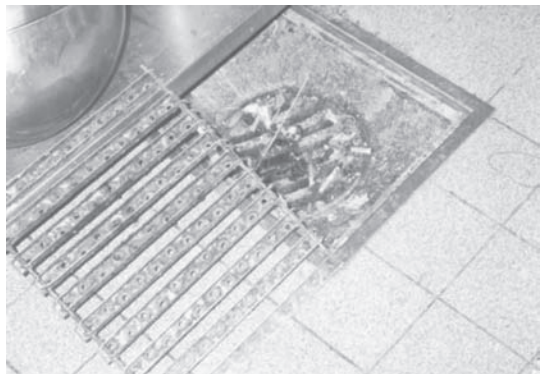
Bild 31: Verunreinigter Bodenabfluss (Quelle: Gemex Hygiene und Vorratsschutz GmbH)
